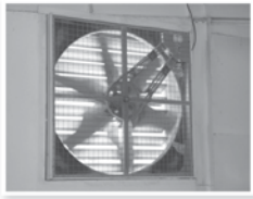
الشكل (٤-١): شفاط لتبديل الهواء.
